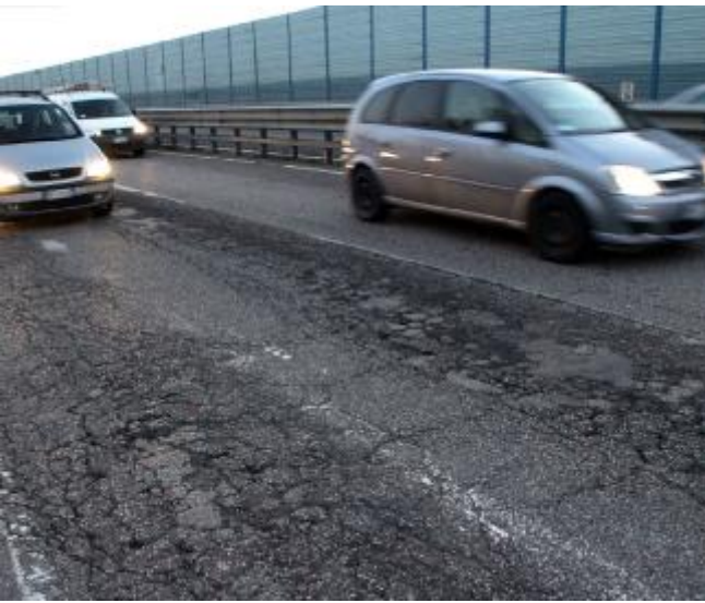
L'asfalto disastroso sulla carreggiata in direzione San Pietro
