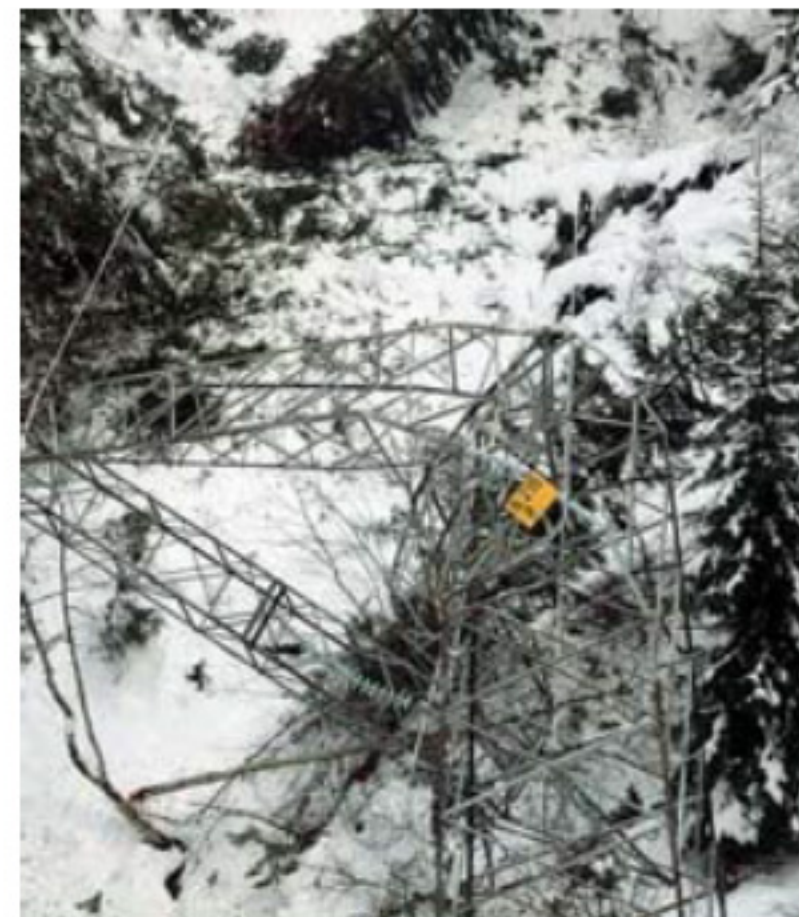
I danni Uno dei tralicci lesionati dalla nevicata del 26 dicembre
